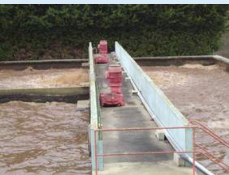
Des systèmes d'épuration inefficaces
